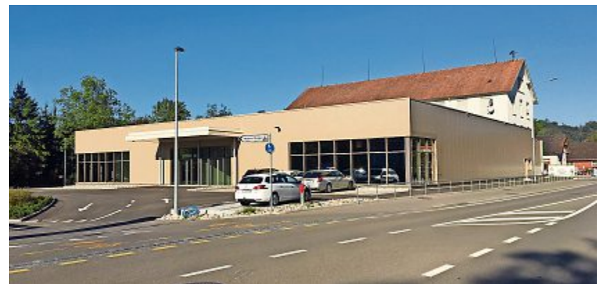
Die Migros Ostschweiz hat mit dem Ausbau des Supermarkts in Matzingen begonnen.
